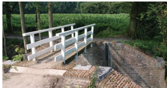
Doorlaatsluis om inundatiewater vast te houden
