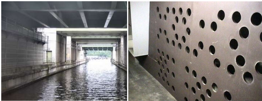
figuur 19 Absorptiemateriaal Schinkelbrug (foto uit: [7]) en frequentiespecifieke Helmholtz resonatoren (foto uit: [8])
