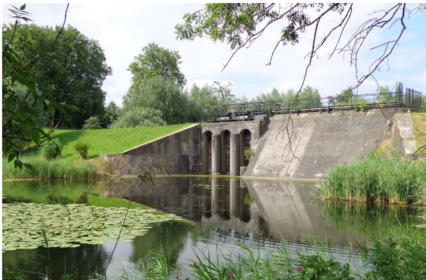
Foto van combinatie van een zogeheten beer en sluis bij Fort bij Everdingen (bron: monumenten.nl)
