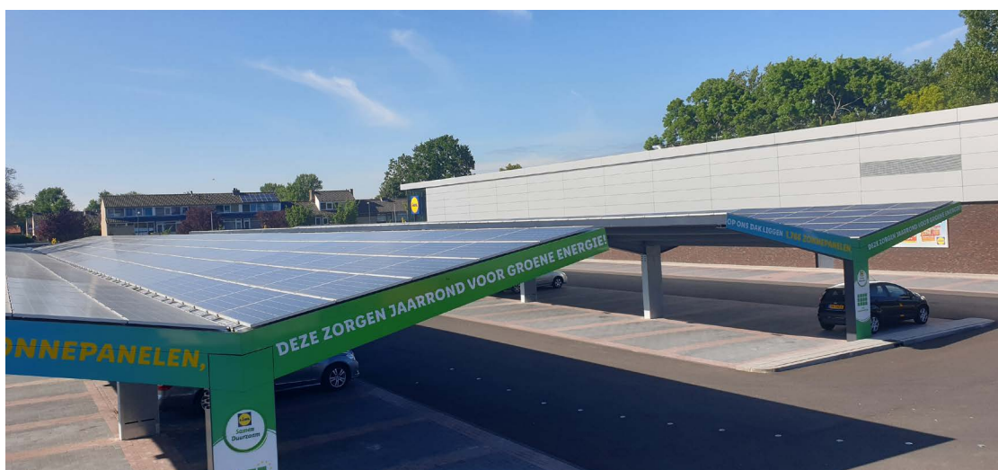
Foto 9.6 Energieopwekking via overkapping van parkeerplaatsen
