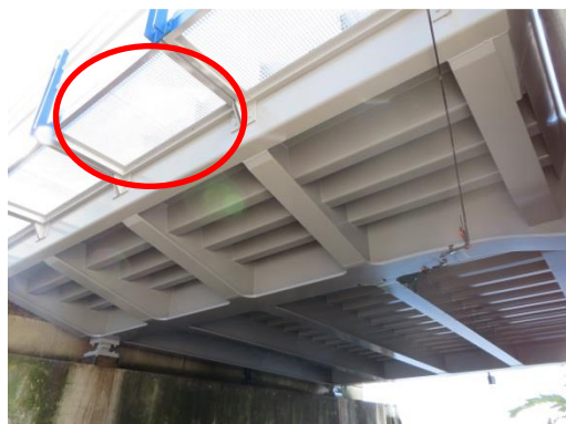
figuur 4 Aangebouwd voetpad in de vorm van een rooster, waardoor minder geluid wordt afgestraald.
